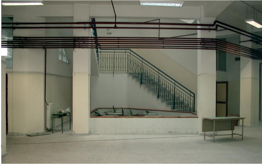
Πριν: το κεντρικό χολ, με εμφανείς τις εγκαταστάσεις θέρμανσης και πυρόσβεσης
